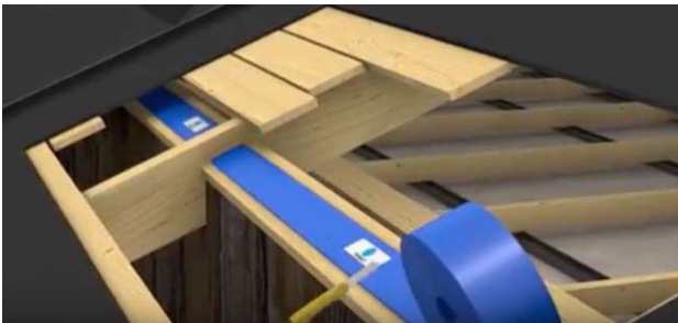
Kuva 2. Leikkaa palokatkonauha haluttuun pituuteen. Palokatkonauha sovitetaan tiiviisti paikalleen räystäään palkkien väliin. Kaikkien liitosten tulee sopia tiiviisti paikoilleen.
